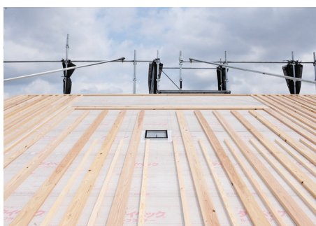
接続ボックス用の開口部を設けた屋根。〈びおソーラー〉では、屋根にたくさんの穴を開けたり、狭い棟部にダクトを取り付ける必要はありません。
