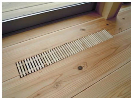
木製床吹出口
