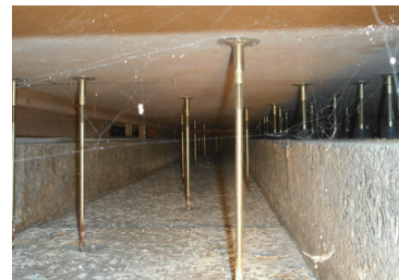
ファンが止まり、長期間放置された床下。
